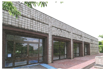
汚れが目立つ外壁（北側）
